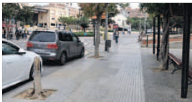
LA ZONA DE LES PISTES DE L'ESBAR, DE LES MÉS DETERIORADES
