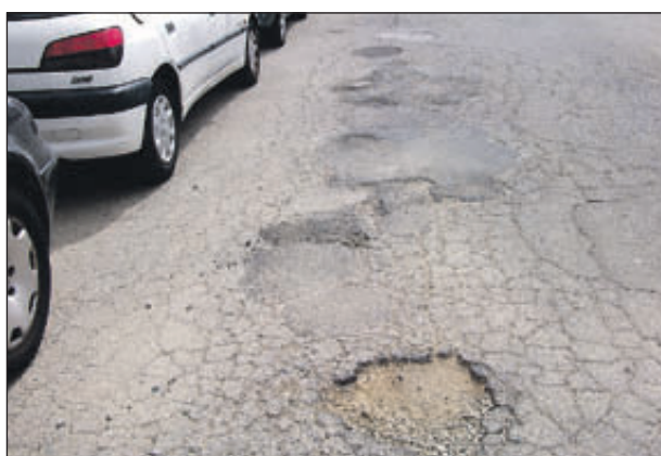
DESPERFECTES DE L'ASFALTAT DEL CARRER DE CERVANTES
