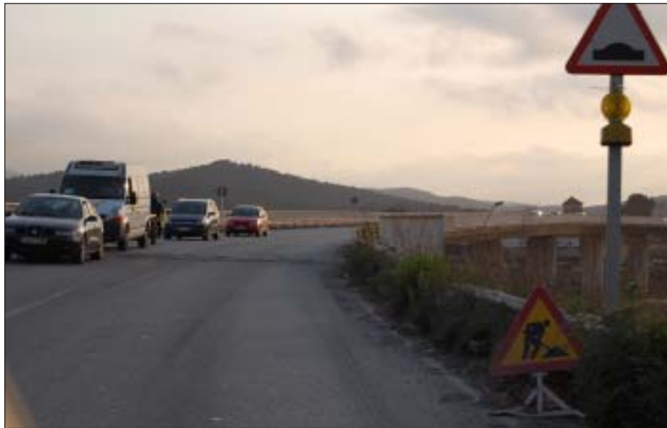
ESTAT DEL PONT, ABANS DE LA REPARACIÓ
